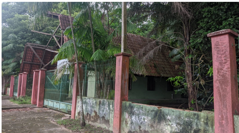
Figura 3 - Guarita de entrada do parque abandonada, com estrutura deteriorada e sem grade de contenção. Fonte: Autores (2024).
